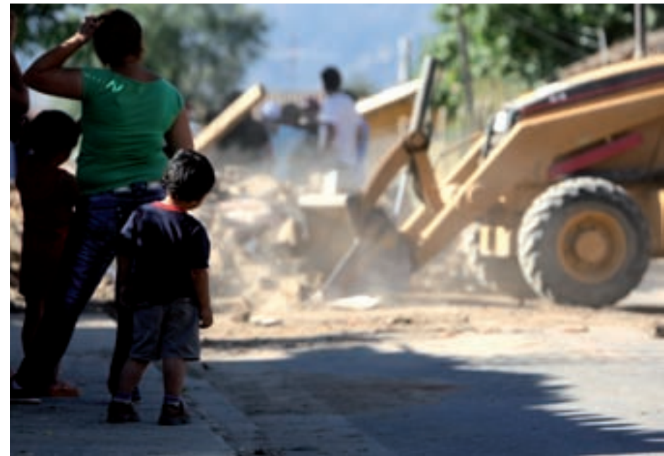
Calles desconectadas por derrumbes y maquinarias trabajando.
