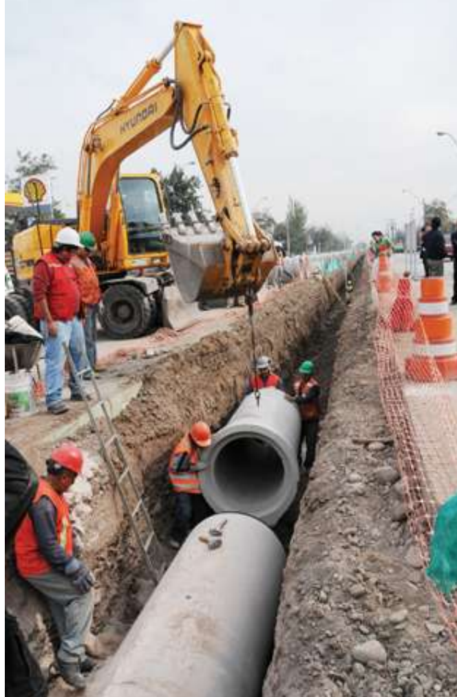
Colector de aguas lluvia, Región Metropolitana
